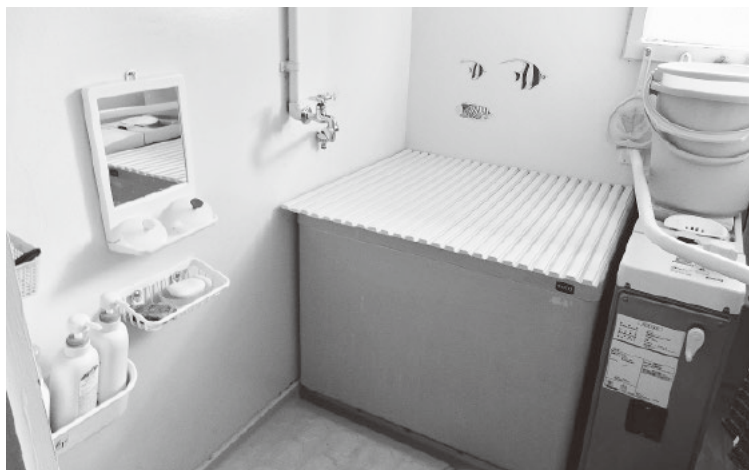
シャワーの設置されていない町営住宅の浴室
