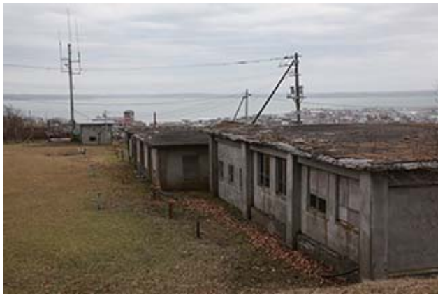
【右下】 配水管の老朽化により、漏水が発生 【左上】 旧宮園配水池 【左下】 平成27年3月から稼働した宮園配水池
