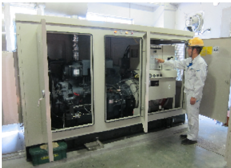
厚岸浄水場に設置している非常 用自家発電設備。停電時に浄水場の 運転を支える重要な設備。
