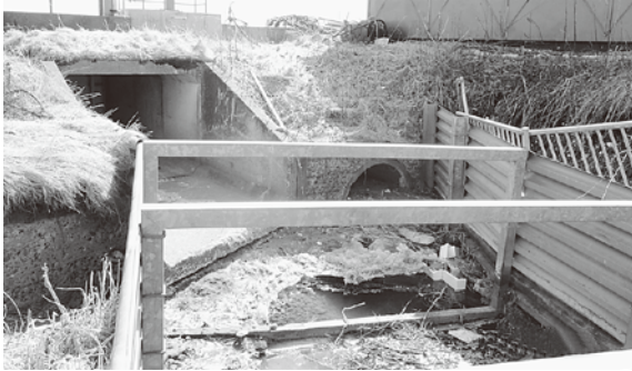
右側開口部が小さく、左側開口部が水面より高い
