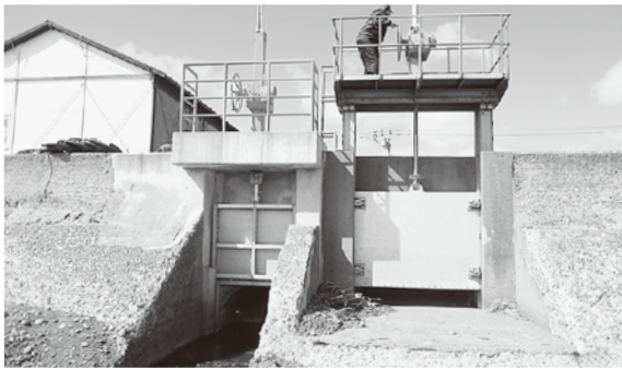
改良が必要な門静前浜地区樋門
