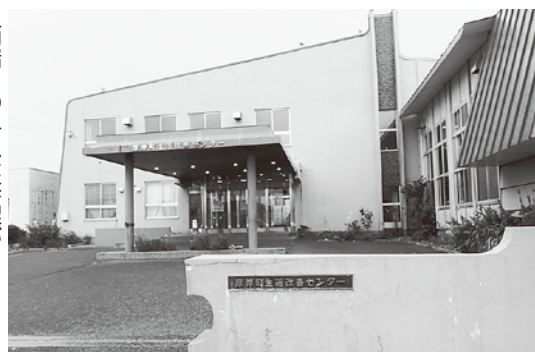
雨漏りの早急な修理が望まれる生活改善センター
