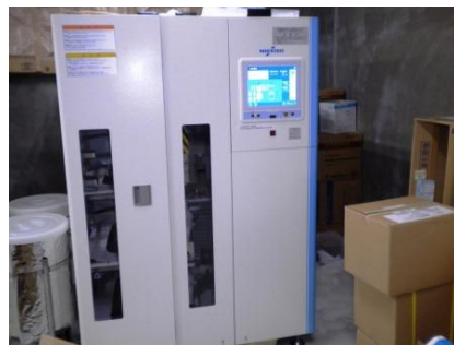
↑ 全自動溶解装置(透析液を作って供給する装置)
