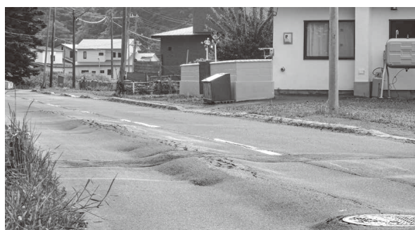
路面が浮き、車の腹をこする奔走湖岸道路
