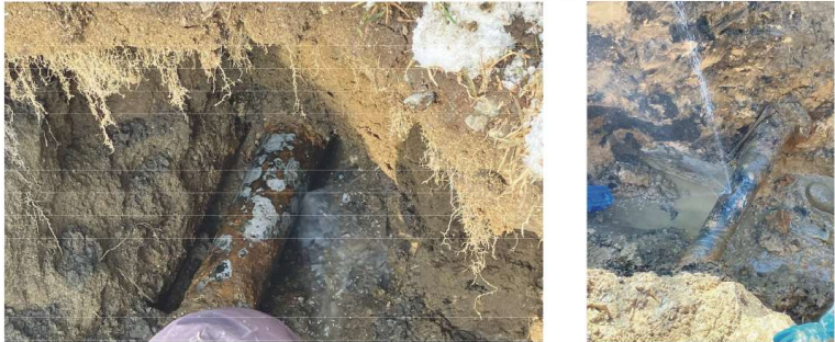
【破損した配水管の様子】
