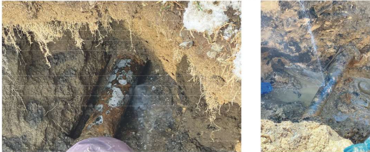
【破損した配水管の様子】
