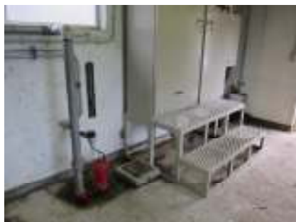
取水ポンプ室の内部。配電盤は嵩上げていたが、約半分が水没しました。
