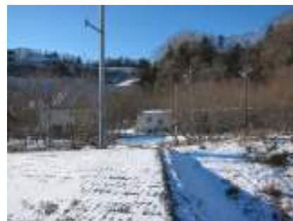
当面の対策となる屋外操作設備の設置場所（手前の電柱に設備）。3 月上旬には完成します。
