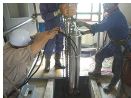
尾幌地区に水を送るポンプ2台を取り替えました
