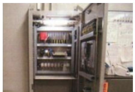
役場庁舎内にあるテレメーター装置（水道施設監視伝送装置）。老朽化した同装置を取り替えた。
